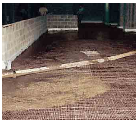
Здание Европарламента в Брюсселе: Существование всего подземного гаража было подвергнуто опасности из-за колебаний уровня грунтовых вод. Решение - DELTA®-MS 20.
